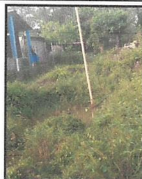
Foto 2: Colapso de Fosa Séptica
